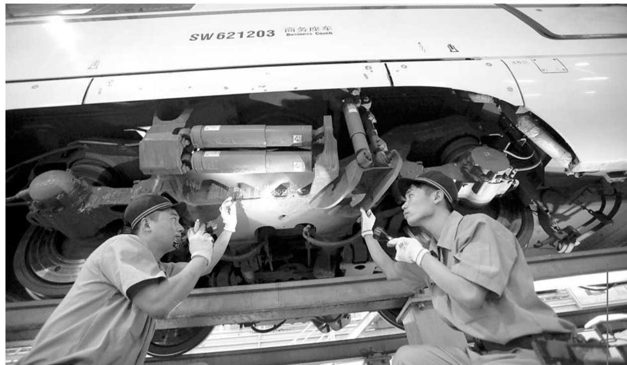
每天都按流程对运行动车组进行检修保养,保证车辆的运行状态,是动车所检修人员的主要职责。该所所长丁兆起告诉记者:“进入暑运以来,气温高、运输作业繁忙,我们全面排查安全风险源点的基础上,精心筛选出81项安全风险点,按流程一一重点检修管控,确保车辆状态良好”。图为7月29日20时,在该厂检修线上,作业人员正在对行驶了21小时4000余公里的G280次广州南—济南西的动车组车底进行精心检修。
