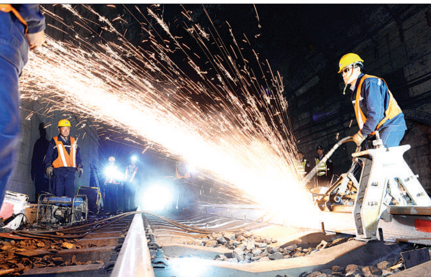
6月8日,大秦铁路全线停运120分钟,进行全线养路施工。大秦铁路是大秦铁路局管辖的一条重载煤运干线,是我国“西煤东运”的战略动脉。因为工人在铁路王家湾港区进行养路施工。 本报记者 周维海摄
