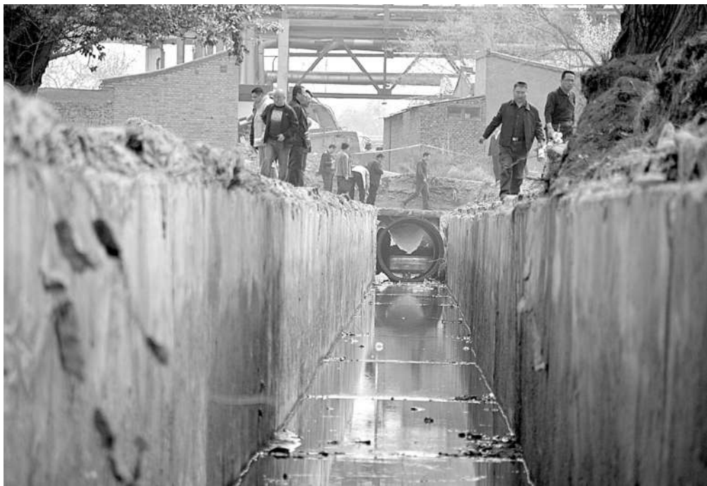
兰州市政府组织相关单位开挖位于兰石化302与303厂之间的自流沟,铺设铸铁管,防止地下水油污渗入自流沟。
