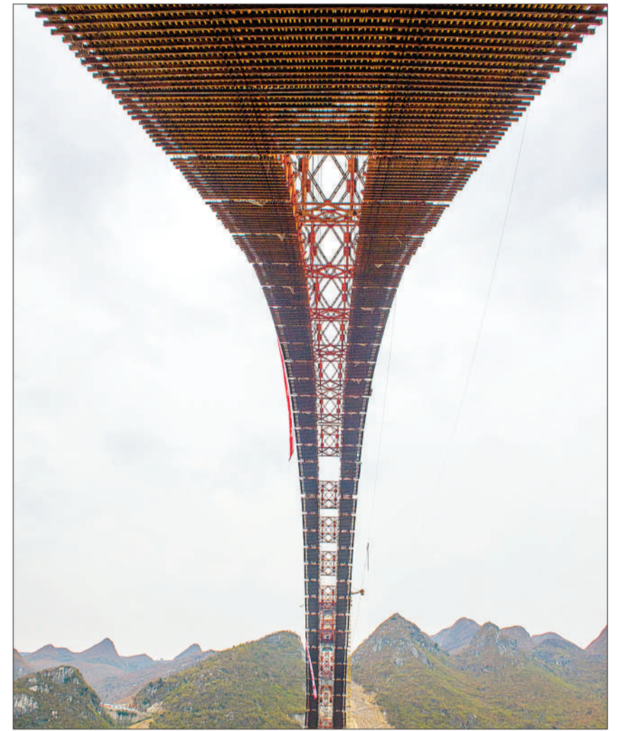
1月12日,位于贵州境内的沪昆铁路客运专线北盘江特大桥钢架主体结构顺利合龙。北盘江特大桥为上承式劲性骨架钢架混凝土拱桥,以一跨形式跨北盘江而过。大桥全长721.25米,其中主桥445米的跨度,在目前世界同类型铁路拱桥中跨度最大。新华社记者 刘续摄
